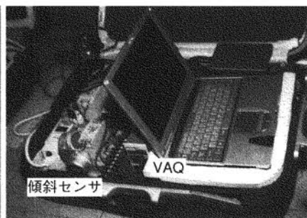
写真2 デッキに設置された機器
